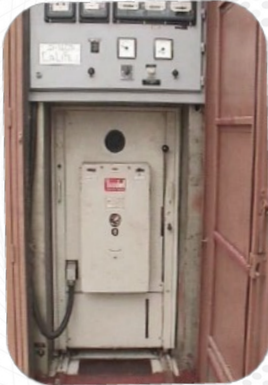
ISODEL (Siemens), 1250A @ 13.8KV
