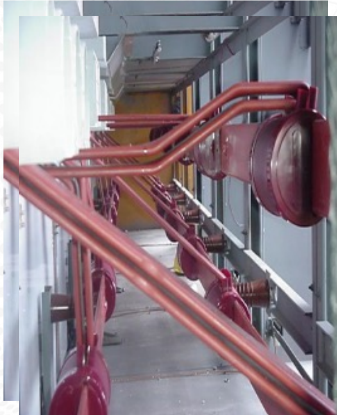
Compartimiento de Barras Repotenciado
